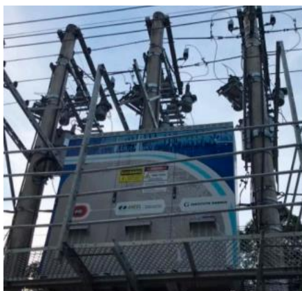
Slika 5. Trofazni VSC konvertor u vanjskoj instalaciji nazivnog napona 13.8 kV [35]
